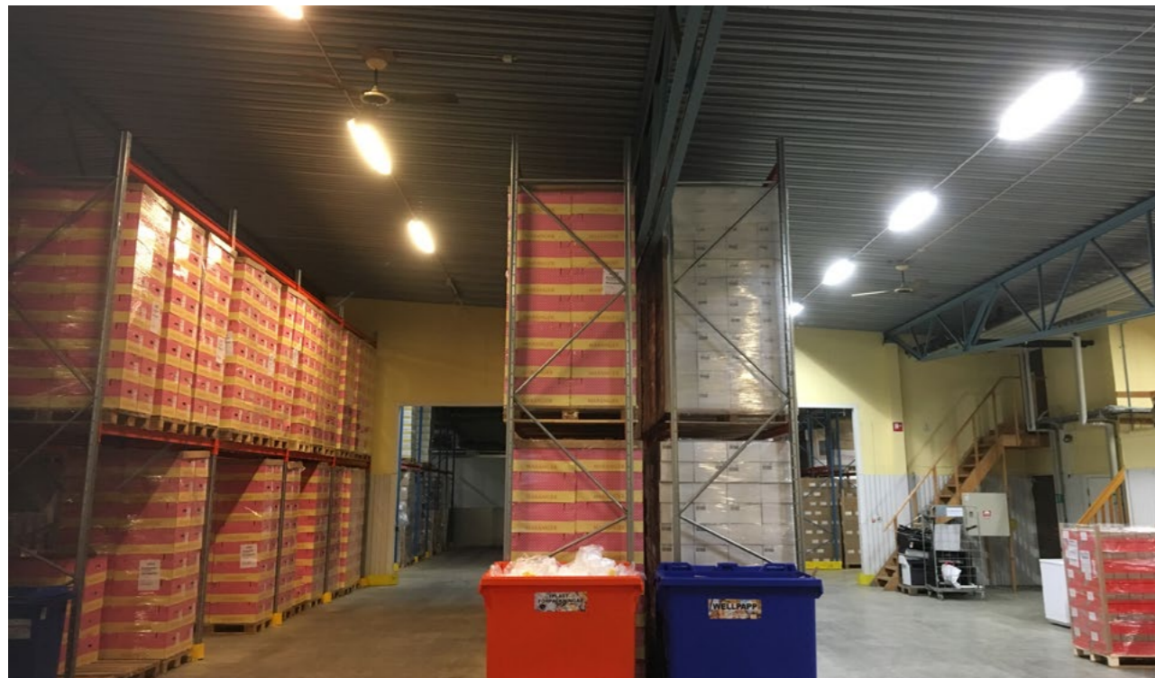
Ny belysning i lagerlokal. Energieffektivisering, minskad elförbrukning med minst 50%, minskad värmeutveckling samt bättre belysning vid byte från konventionella lysrör till led belysning.
